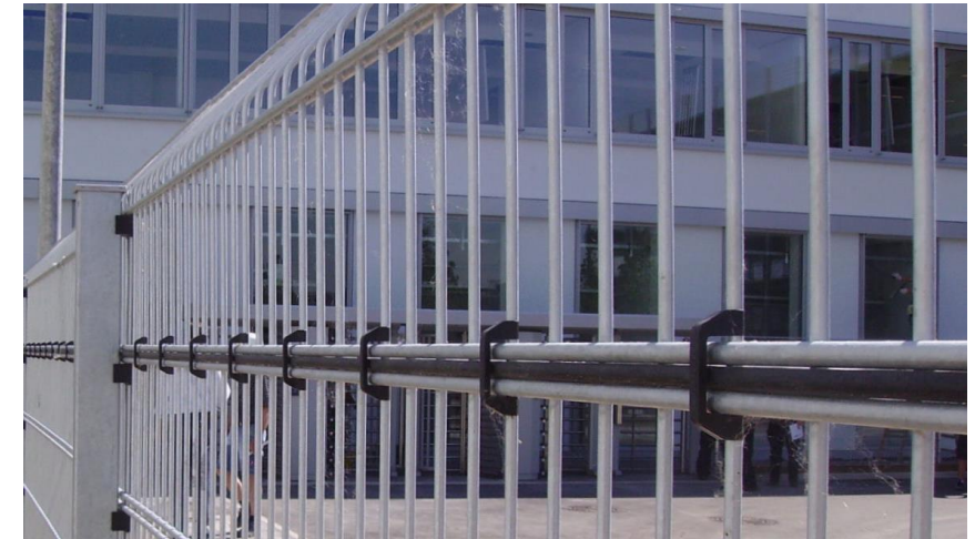
Eine aufgeräumte Kabelführung (Ansicht: nicht-Angriffsseite)
